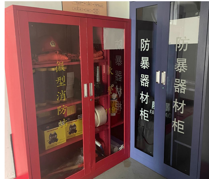
公司办公地点配备消防设备
